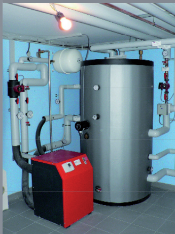
Heizungsanlage mit Wärmepumpe
